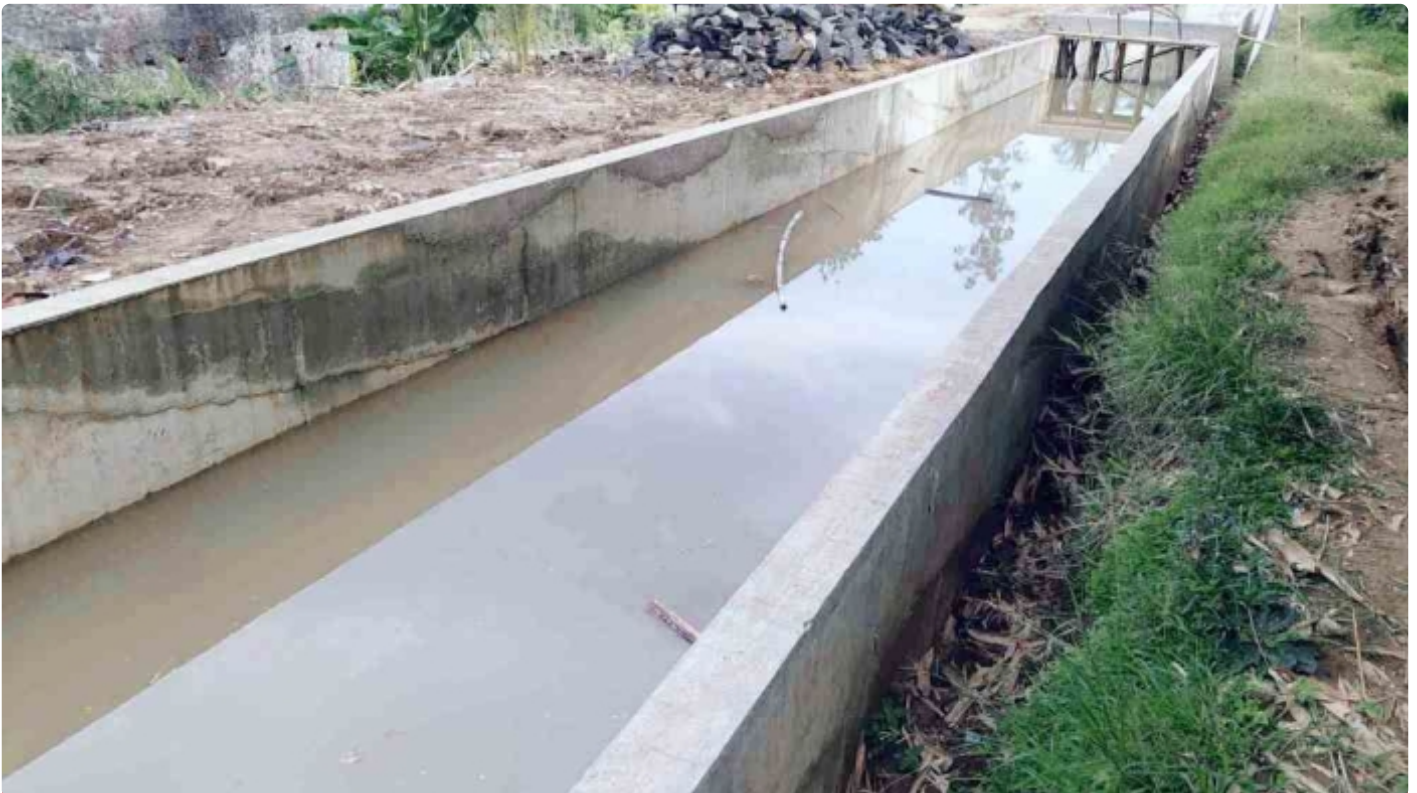
Terlihat banyak tambalan dan retak pada konstruksi DI Cibinuang
