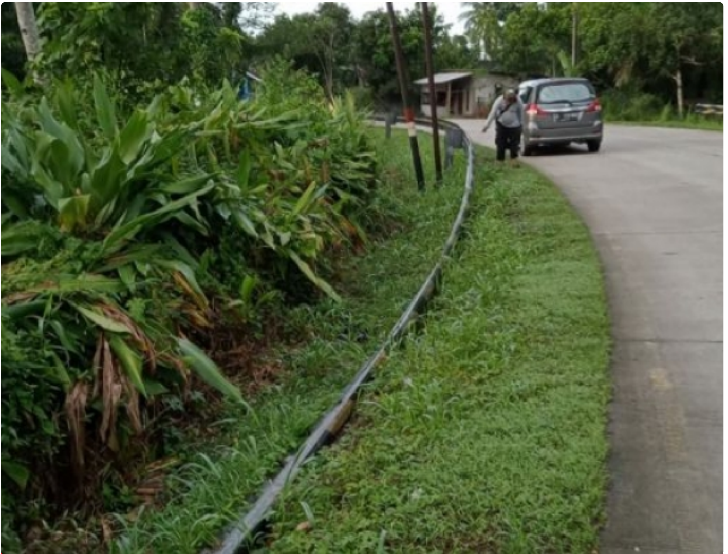
Nampak guard rail di jalan turun ke bawah karena tiangnya di curi
