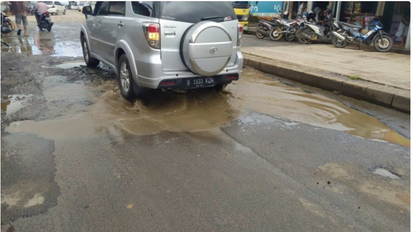
Nampak jalan protokol Malingping rusak berlubang dan digenangi
